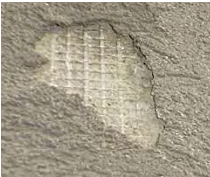
Distacco superficiale del rivestimento di finitura
