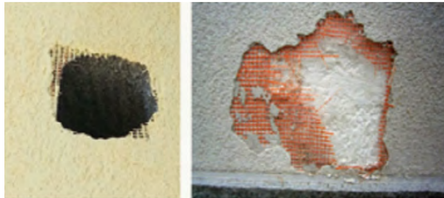
Esempi di errato incollaggio della rete
